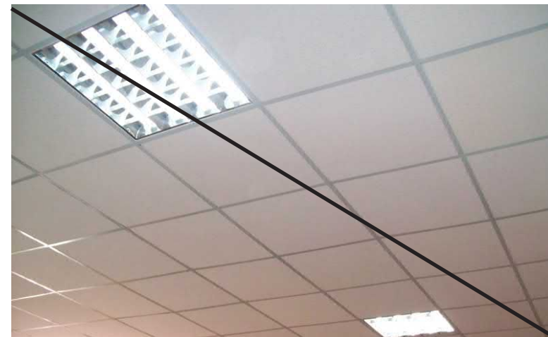
Плохо Открытые направляющие
